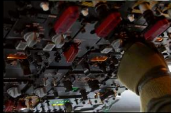
Mise en route moteur 3
